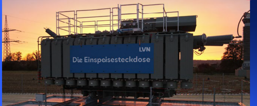
LVN schafft Anschlusskapazität: Die Einspeisesteckdose bringt erneuerbare Projekte schneller ans Netz.
