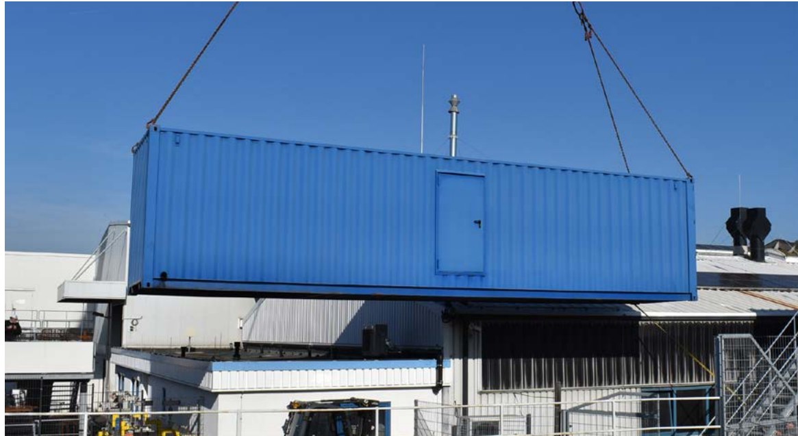
Aufstellung des Biofilters in Containerform.
