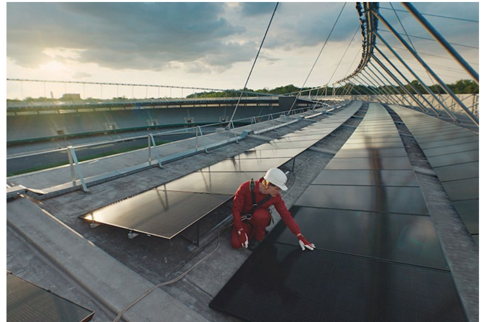
Solarmodule auf einem Stadionsdach
