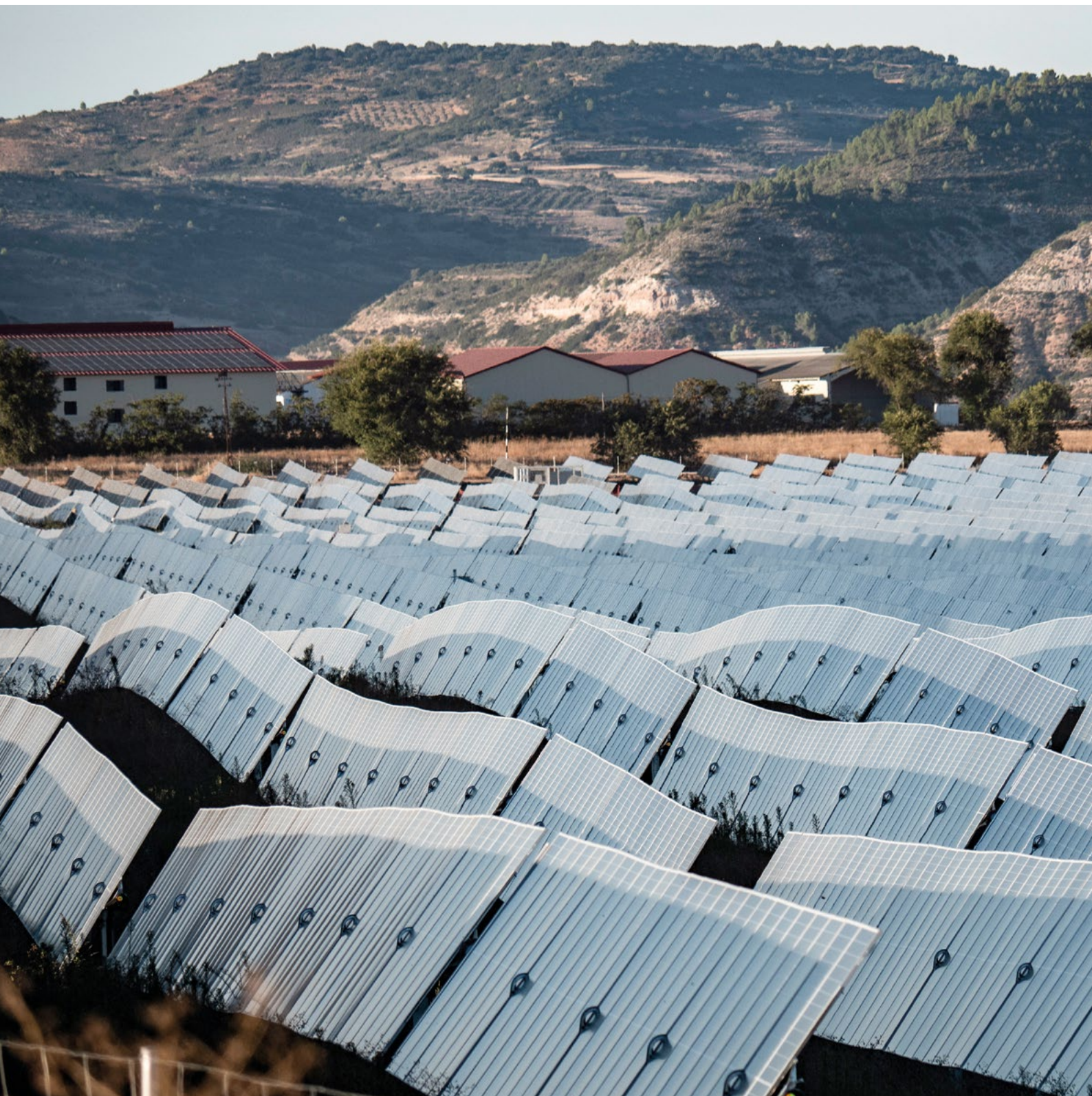
Die Solaranlage Valdezorita in Spanien hat eine installierte Leistung von 50 Megawatt und soll im ersten Quartal 2025 ans Netz gehen.
