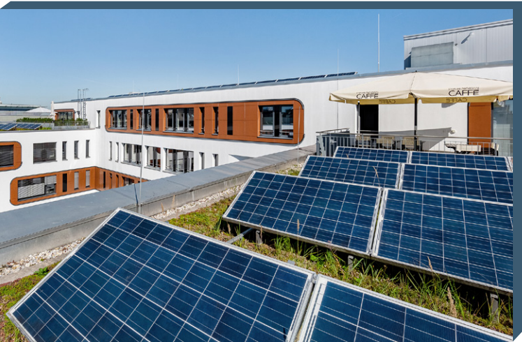
SOLARPANELS auf dem „NuOffice“ in München, Domagkstraße
